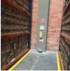
Extintores por pasillo bodega señalización espacios y bodega
